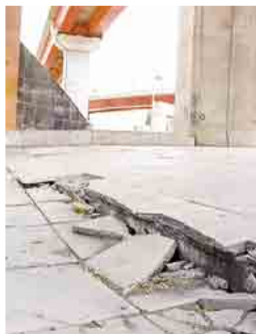
Sin peligro. El Estado informó que son daños no estructurales.
